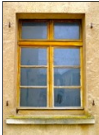
Dieses Fenster wurde seit seiner Herstellung und Konservierung mit Leinöl im Jahr 1939 nicht mehr gepflegt. Es ist dennoch kein Schaden entstanden. – Eine Wiederholung der Konservierung und ein neuer Anstrich mit Leinölfarbe kann dieses Fenster für die nächsten 75 Jahre wieder dauerhaft schützen.
