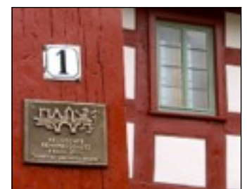
Wiederhergestellte Konservierung mit Leinöl und Leinölfarbe an Fachwerk und Fenster. Hessischer Denkmalschutzpreis 2010.
